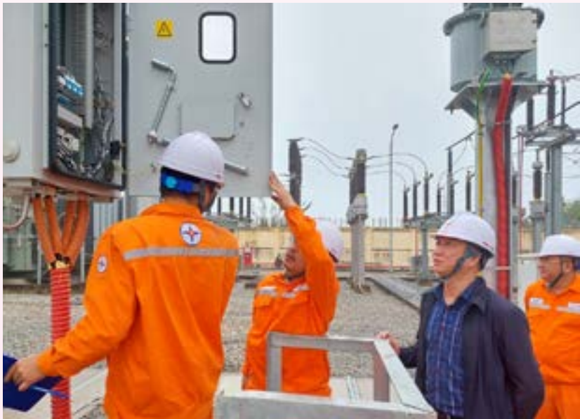
Lãnh đạo Công ty Điện lực Yên Bái kiểm tra thiết bị trước khi đóng điện
